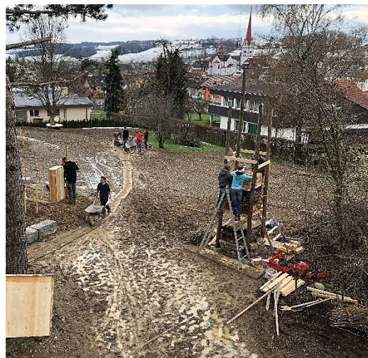
Schulraumgestaltung Lebensturm / Biologie
